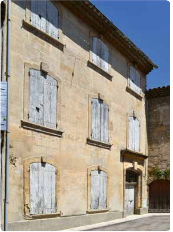
Exemple de RAVALEMENT D'ENTRETIEN à réaliser
