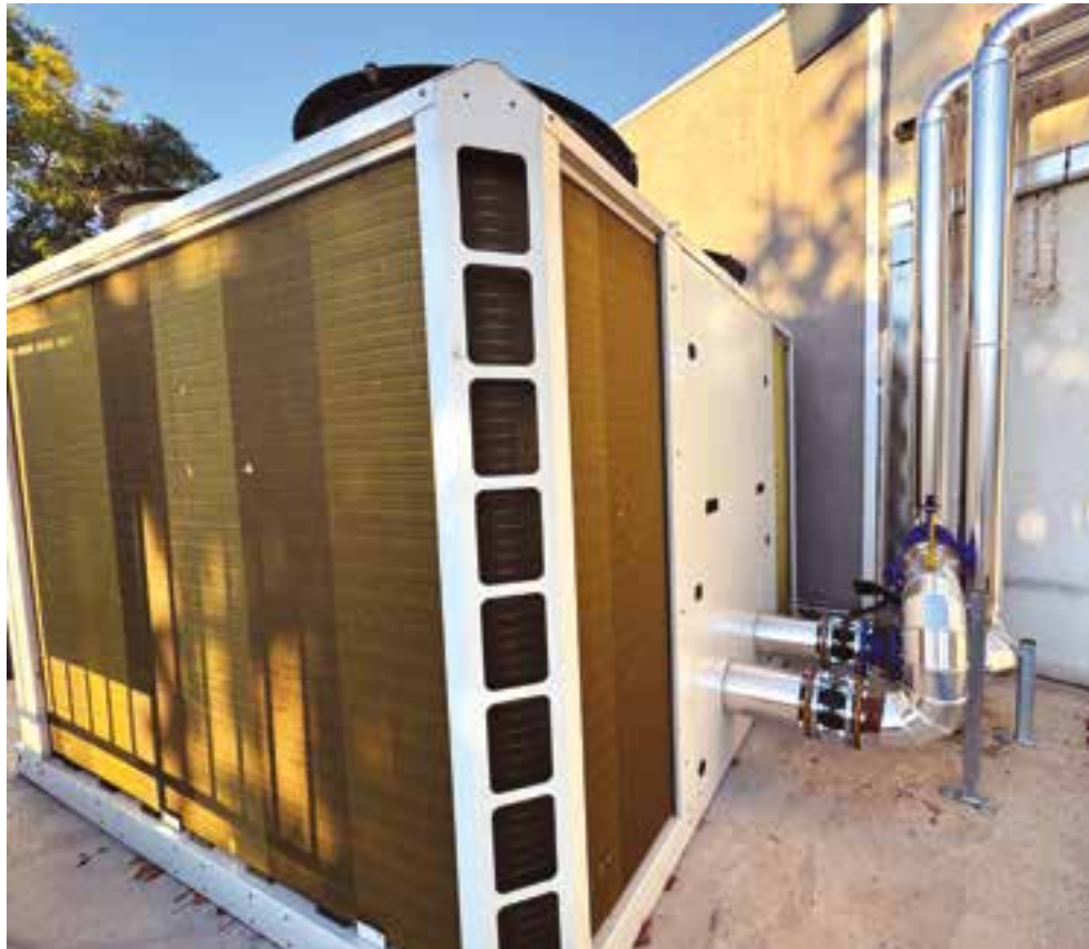
La nouvelle chaufferie de l'école Camille-Pierron
